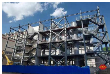
电厂化学链矿化项目
