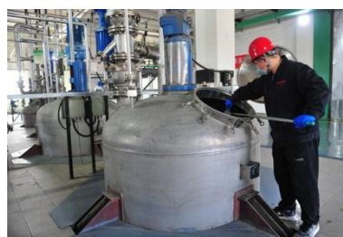
渣铁处理反应罐取样
