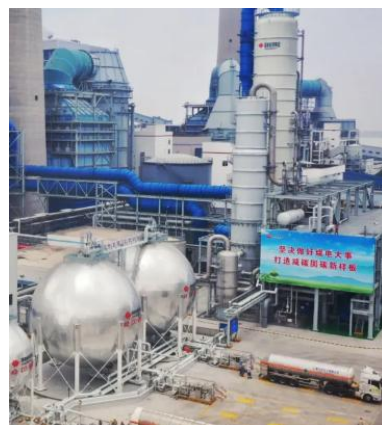
泰州电厂 CCUS 项目
