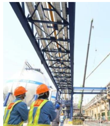
齐鲁石化 CO 2 管道
